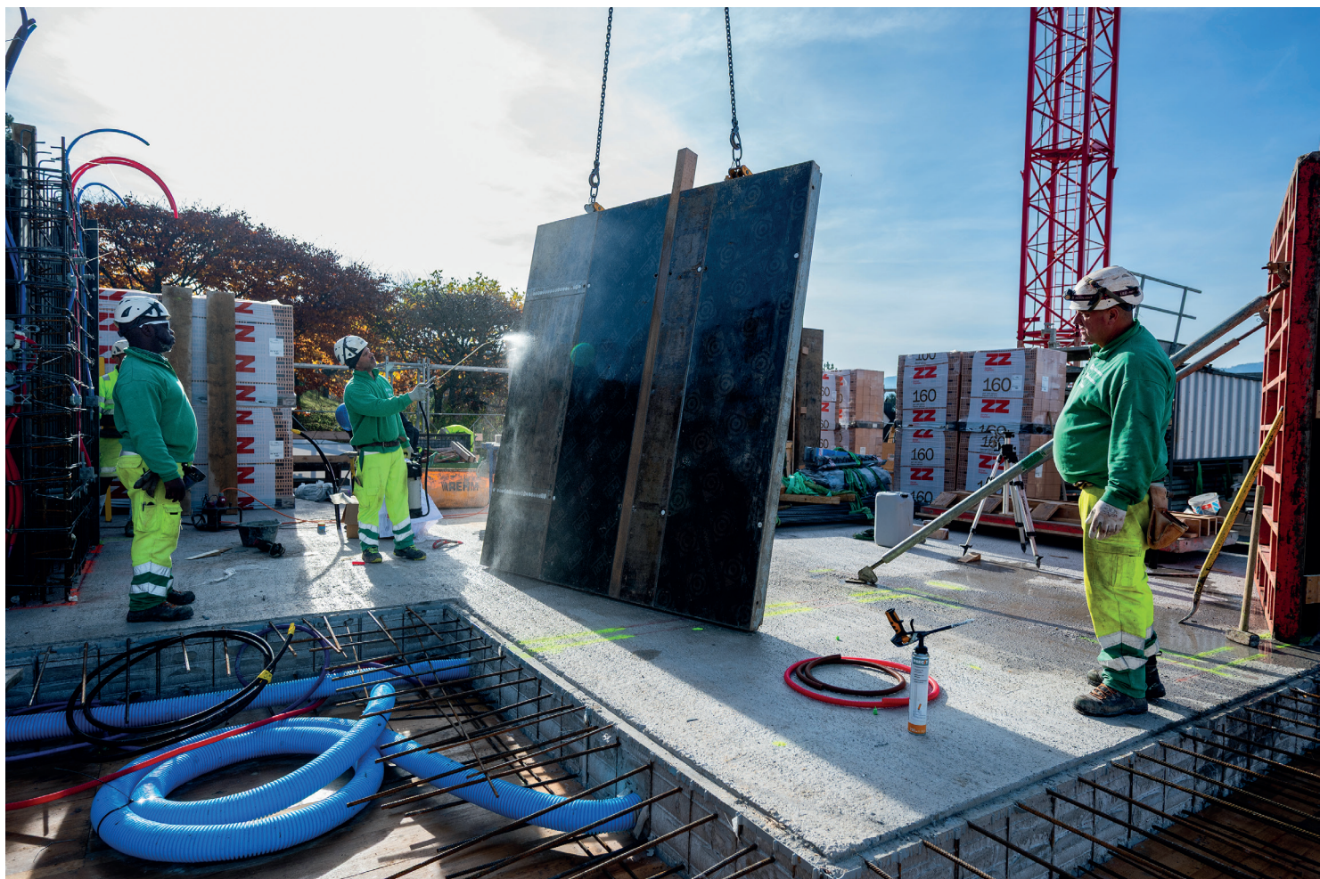
Schalen im Schnellzugtempo: Der Bau in Erlenbach erfordert hohe Qualität in kürzester Zeit.
