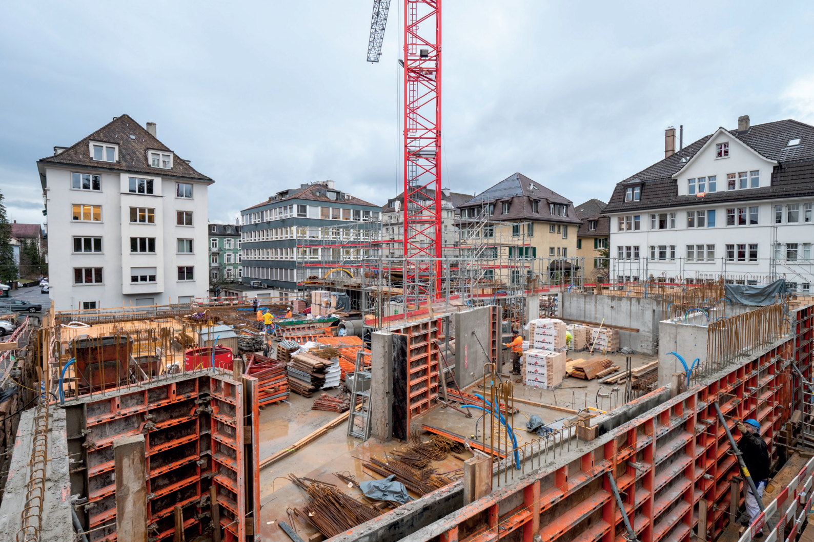
Der Bauplatz «Minervastrasse» in Zürich ist auf allen Seiten von Strassen umzingelt.
