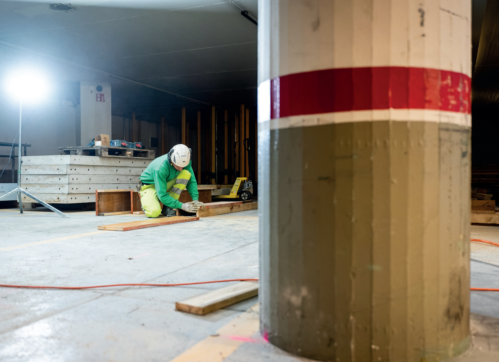
Weil oben die Asbest-Sanierung länger dauert, ist das Baur-Team erst im Untergrund tätig.
